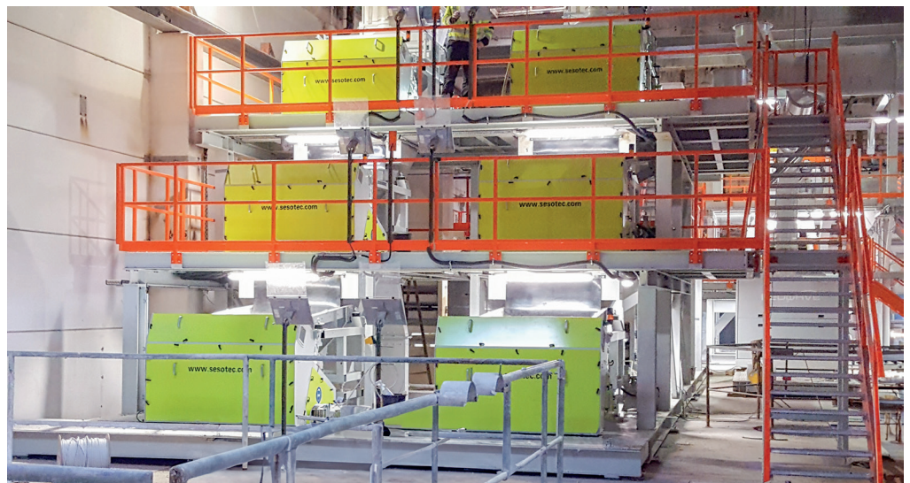
Am Reiling Recyclingstandort im dänischen Naestved werden zur Aufbereitung von Hohl- und Flachglas SPEKTRUM Glassortiersysteme von Sesotec eingesetzt (Foto: Reiling Gruppe)
